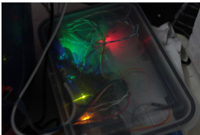
Figura 48: Circuito dentro da caixa fechada
